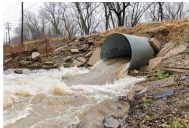
FIGURA W5. Abertura de alcantarilla casi sumergida con una fuerte escorrentía que ingresa a la abertura, lo que crea una poderosa succión y un peligro para cualquier persona que se encuentre frente a dicha abertura.
